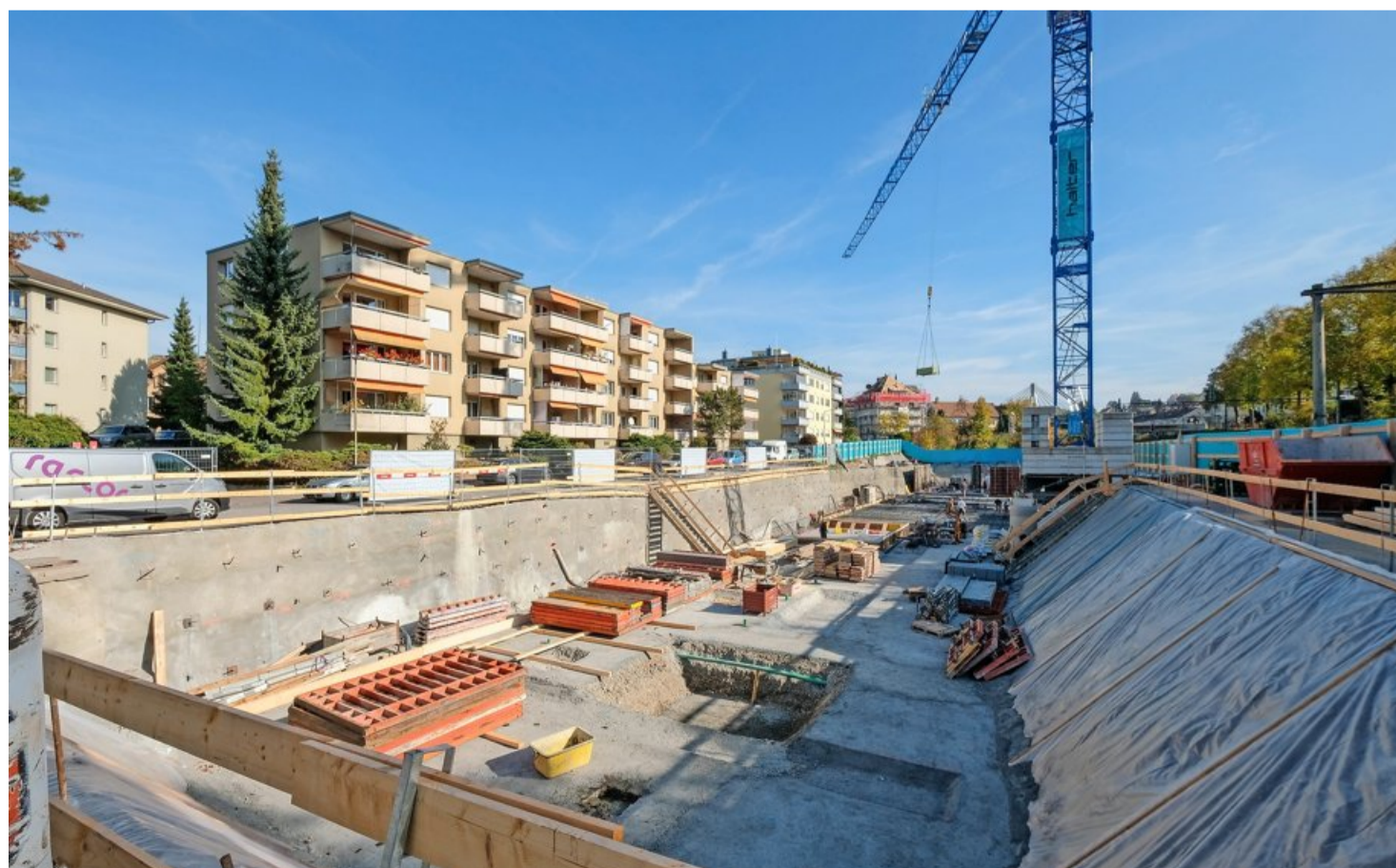
Zwischen der Tössfeldstrasse und den Bahngleisen verläuft die Baugrube. Bis Anfang 2020 werden hier 49 Wohnungen gebaut.
